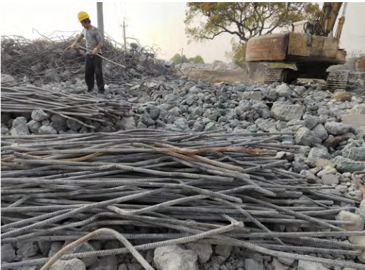
在杭州恒隆廣場拆解臨時混凝土支架 以回收鋼筋和混凝土碎片
