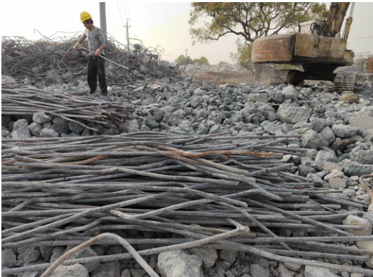
在杭州恒隆广场拆解临时混凝土支架 以回收钢筋和混凝土碎片
