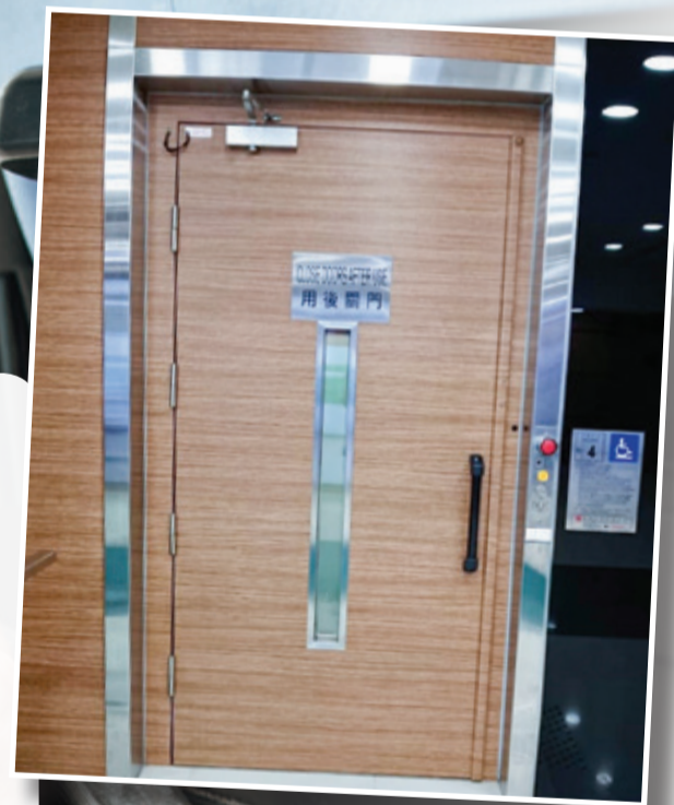
▲ 位于雅兰中心办公楼二期的垂直升降台 The vertical lifting platform at the Grand Plaza Office Tower II
